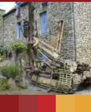
1 et 2 / Forage pour sondes (140m) dans le cadre d'une rénovation en Ile-et-Vilaine. ©GE-THERMIE Forages.
