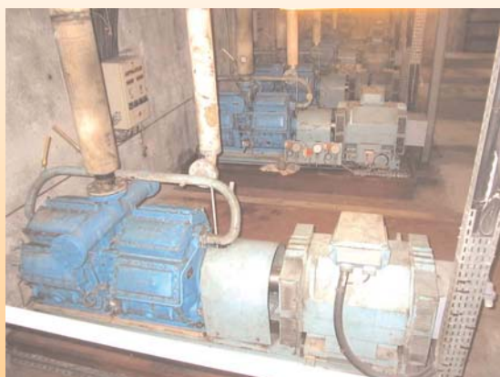
Moteur électrique - Compresseur
