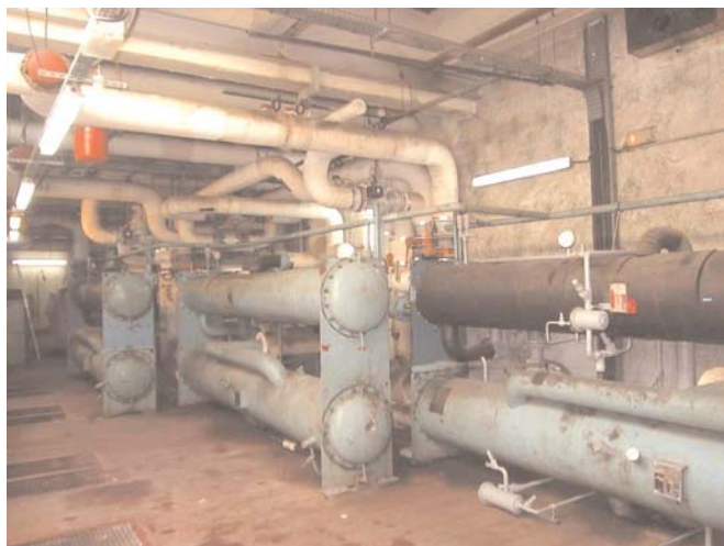
Condenseurs et évaporateurs
