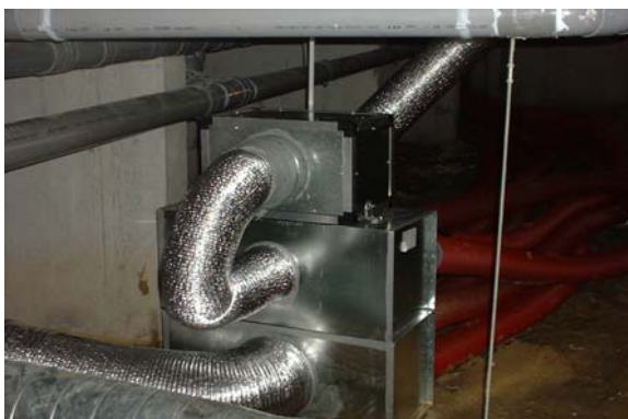
Distribution en vide sanitaire
