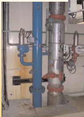
Conduite de production calorifugée et conduite de ré-injection (en bleu)
