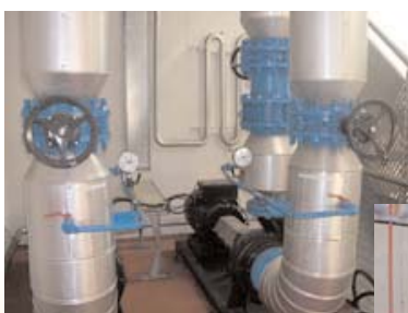
Pompes de cogénération
